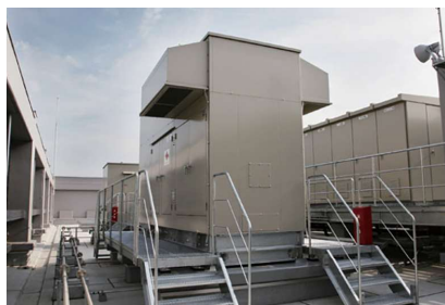
データセンター設備の維持管理業務、システム運行管理業務
